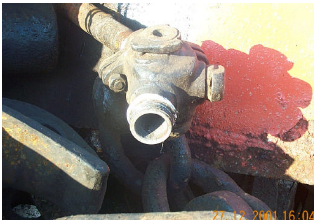
Gambar 6. Pipa yang terputus
